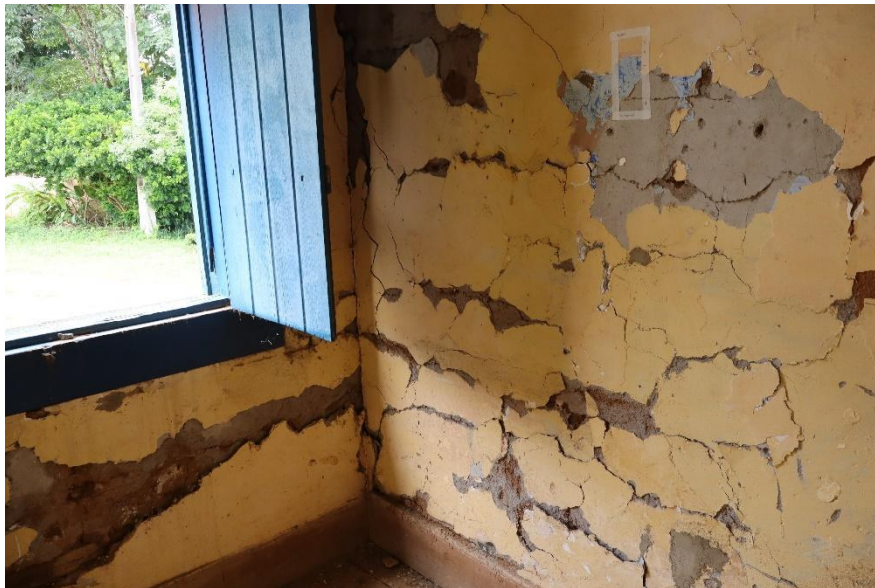
Desplacamentos do reboco. Foto: Tayami Fonseca, 2024.
