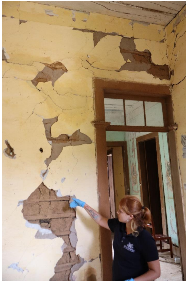
Desplacamentos do reboco. Foto: Tayami Fonseca, 2024.
