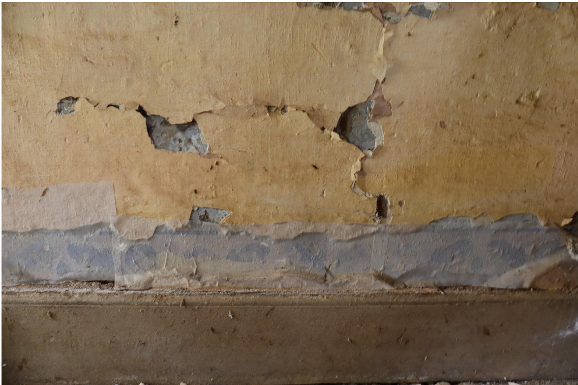
Desprendimentos da camada pictórica. Foto: Tayami Fonseca, 2024.
